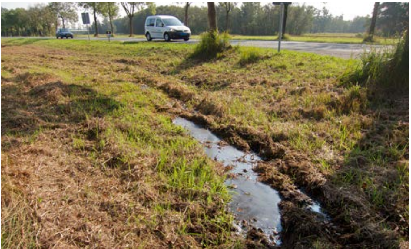
Insporing ontstaan tijdens werkzaamheden in de berm (Bron: Jan Dirk Buizer, Bureau Waardenburg)
