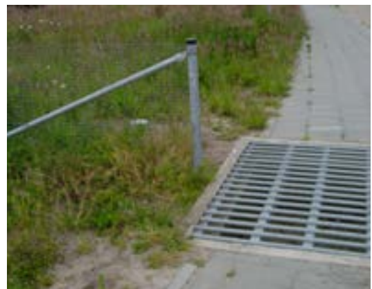
Het raster sluit niet goed aan op het wildrooster. Er is ruimte waar dieren tussen de paal en het raster door kunnen glippen
