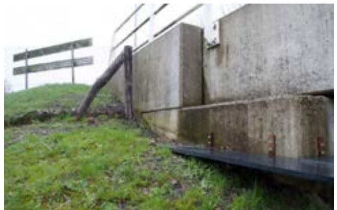
Een loopplank die goed aansluit op de oever. Helaas sluit het raster niet goed aan op het kunstwerk. Er is ruimte voor kleine dieren om het raster te passeren. Met een metalen hoekprofiel of standaard muuraansluiting is dit te voorkomen (Bron: Lieveke Crombach, Provincie Overijssel)
