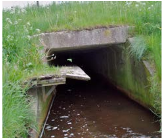
Een houten loopplank is in het algemeen niet duurzaam (Bron: Hans Bekker, RWS)
