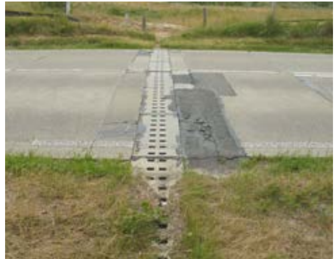
Schade aan wegdek door aanwezigheid amfibieëntunnel. Geeft tevens geluidsoverlast (Bron: Nico Jonker, Provincie Noord-Holland)
