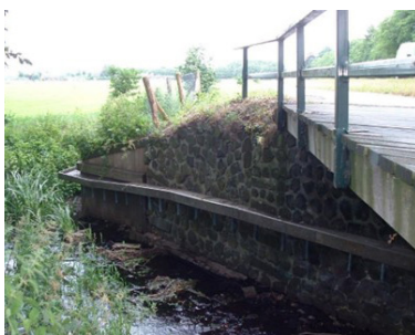
Figuur 4- 13: Houten looprichel loopt ver genoeg door en sluit op de oever aan. Deze is echter hoog boven het wateroppervlak geplaatst waardoor dieren mogelijk de ingang niet zullen vinden.
