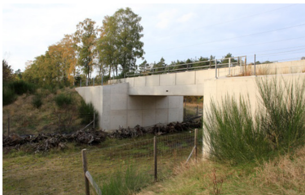
Figuur 5- 4: Grote onderdoorgang onder een spoorlijn in Nederland, die door de korte lengte zeer open is. Voorbeeld van een goede aansluiting van de ecorasters en de geleidende stronkenwal.
