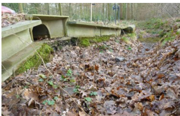
Figuur 9- 30: Amfibieënvoorziening (Kerkedreef, Brasschaat) die niet meer mooi aansluit op de omgeving door weggespoelde grond (Bron: Lotte Gielis). De tunnel staat ook regelmatig onder water.
