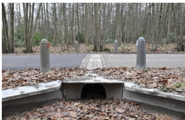
Figuur 4- 38: Een tunnel uit prefab-elementen met gaten in het dak, mooi aangesloten aan de geleidende structuren. De geleiding is van dien aard dat dieren die toch op de baan geraakt zijn, kunnen terugkeren.
