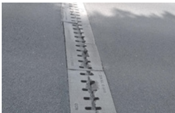
Figuur 4- 36: Voorbeeld een tunnel uit prefab elementen met openingen in het dak (N437 Kruisem/Lozer). Hierbij zijn duidelijk barsten te zien als gevolg van verzakkingen door inconsistentie van de funderingen in het wegdek.
