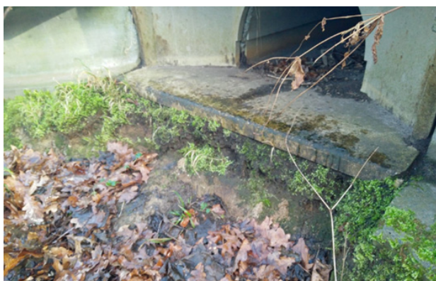
Figuur 4- 35: Voorbeeld van een tunnel waarvan de aansluiting niet voldoende verzekerd is door wegspoelen van grond.
