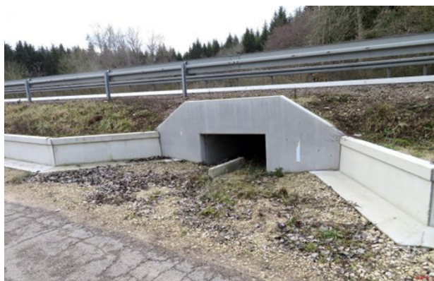
Figuur 4-40: Gesloten koker met mooi aangesloten geleidingsstructuur, met een stopwand ter hoogte van de tunnelingang.
