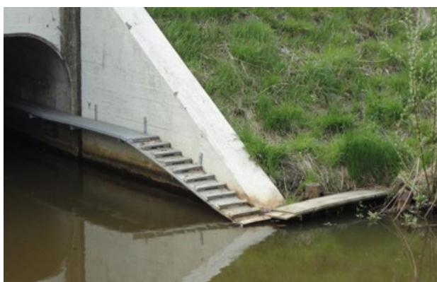
Figuur 4- 19: Duiker met een looprichel en schuine aanloopplank. De hoek met de aansluiting op de oever is aan vervanging toe.
