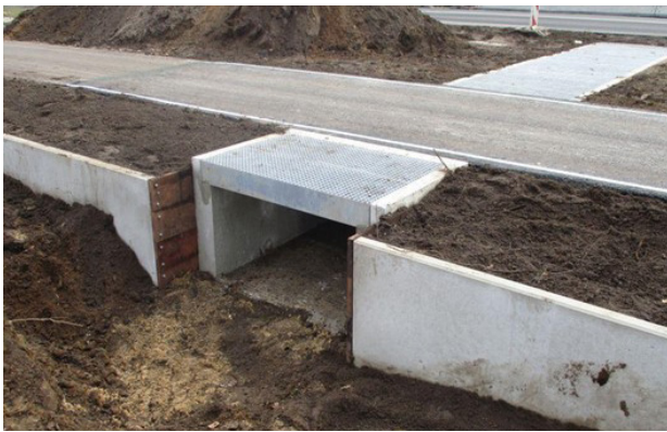
Figuur 4- 44: Recent aangelegde tunnel met open structuur en goede aansluiting aan de geleidingsstructuur. De tunnelingang en tunnel zelf moeten nog ingericht worden en de werking ervan moet nog worden aangetoond.
