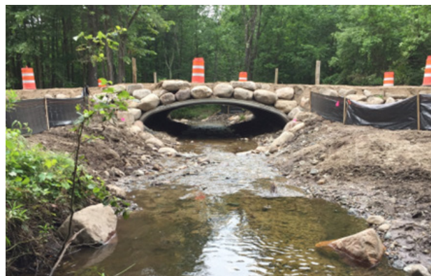
Figuur 4- 29: Voorbeeld van een recent aangelegde duiker waarin de natuurlijke stroom van de waterloop en de oevers doorlopen. Voor de tunnel is er door de werken een riffle ontstaan die mogelijk een te hoge stroomsnelheid heeft om passeerbaar te zijn voor sommige vissoorten.
