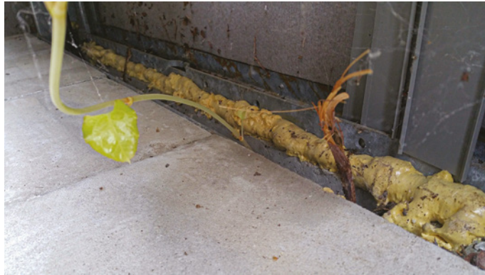
Figure 3-19 : Renouée se développant à l'intérieur d'une guérite électrique (SNCF Réseau)
