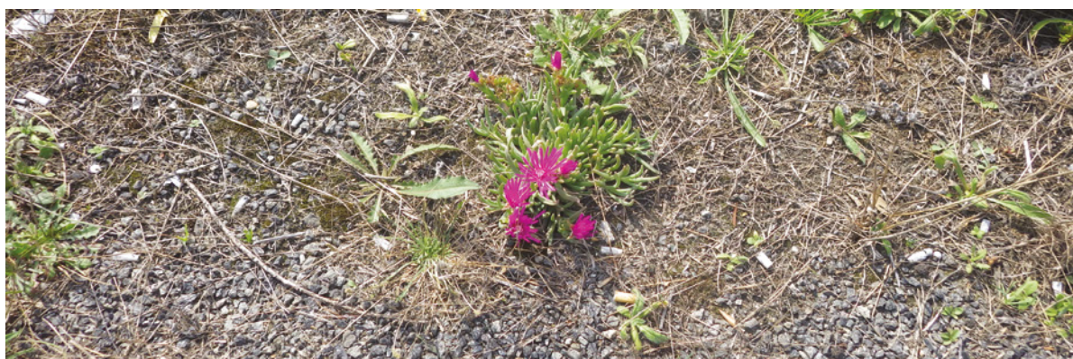
Figure 5-1 : Griffe de sorcière au premier stade de colonisation (Cerema)
